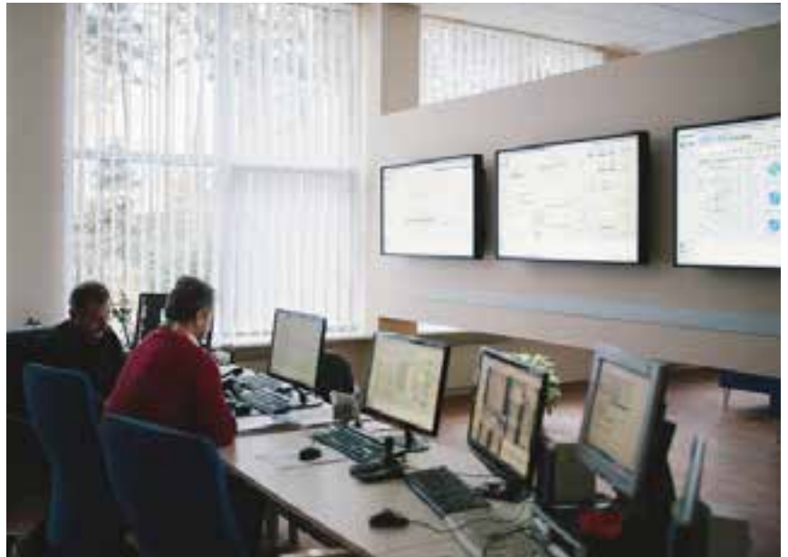
Jonas Klebonas (li.) Schaltzentrale der Schlammbehandlungsanlage (u.)
